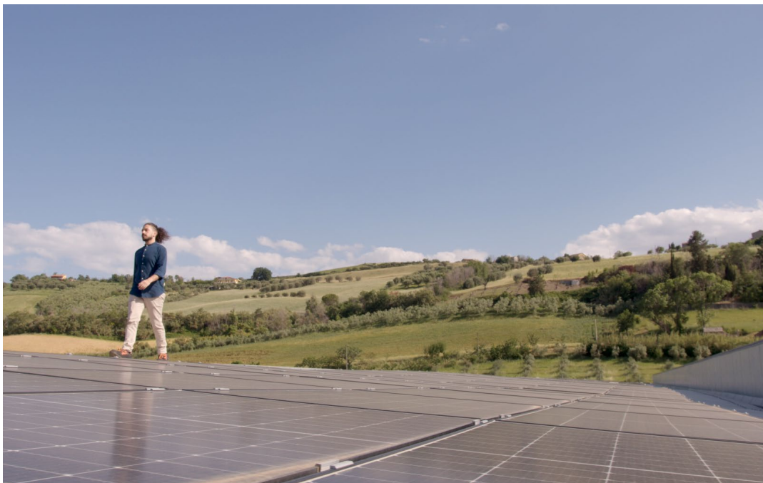
L'impianto fotovoltaico della sede di Casoli di Atri (TE).
